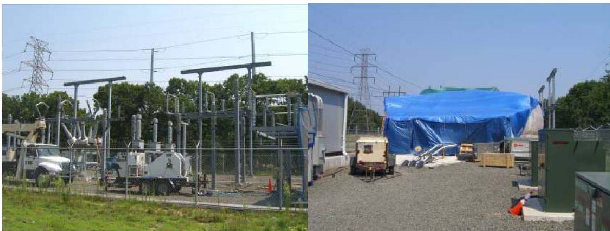
Рис. 3. Токовводные муфты ВТСП кабеля LIPA на площадке (слева) и вводы в кабельные каналы (справа).
