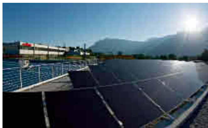
Рис. 1. Солнечные модули на поверхности здания
